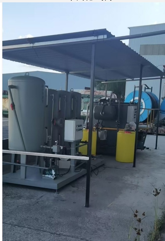
污水处理设施
