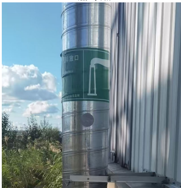
DA002 排气筒监测孔
