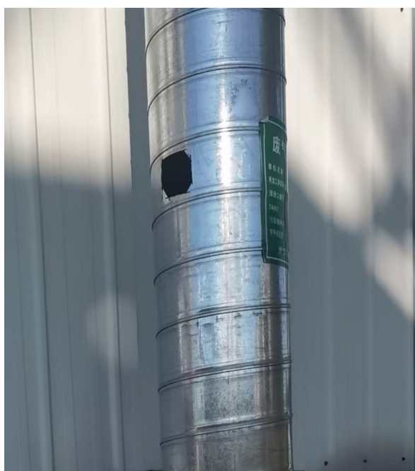
DA001排气筒监测孔
